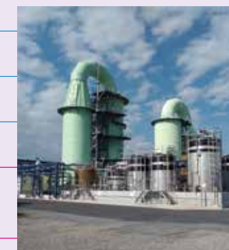
K&Oヨウ素（株）ブローアウト法設備
